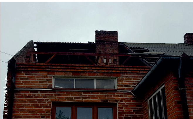
Zerwane dachy gospodarstw
